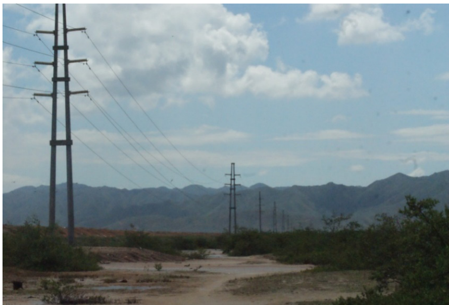
Fig. 2. Tendido de transmisión eléctrica sobre el istmo de Chacopata, estado Sucre, Venezuela.
